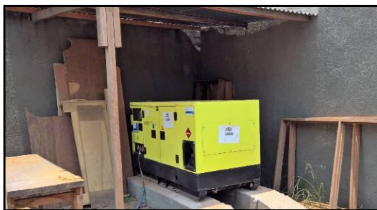
De generator staat onder een stevig afdak en op een stevige ondergrond.
